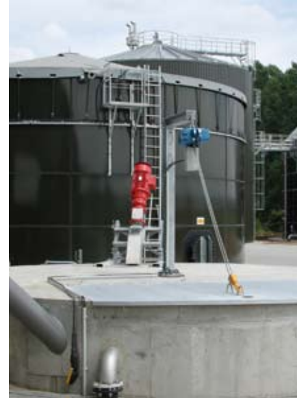
Biogasanlage Schloss Wissen – Blick auf die Vorgrube, den Vorlagenbehälter und den Fermenter
